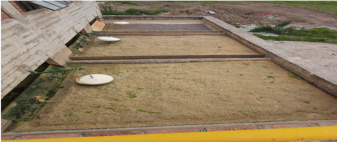
Vista de los filtros de graba
