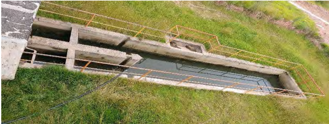
Desarenador de material particulado
