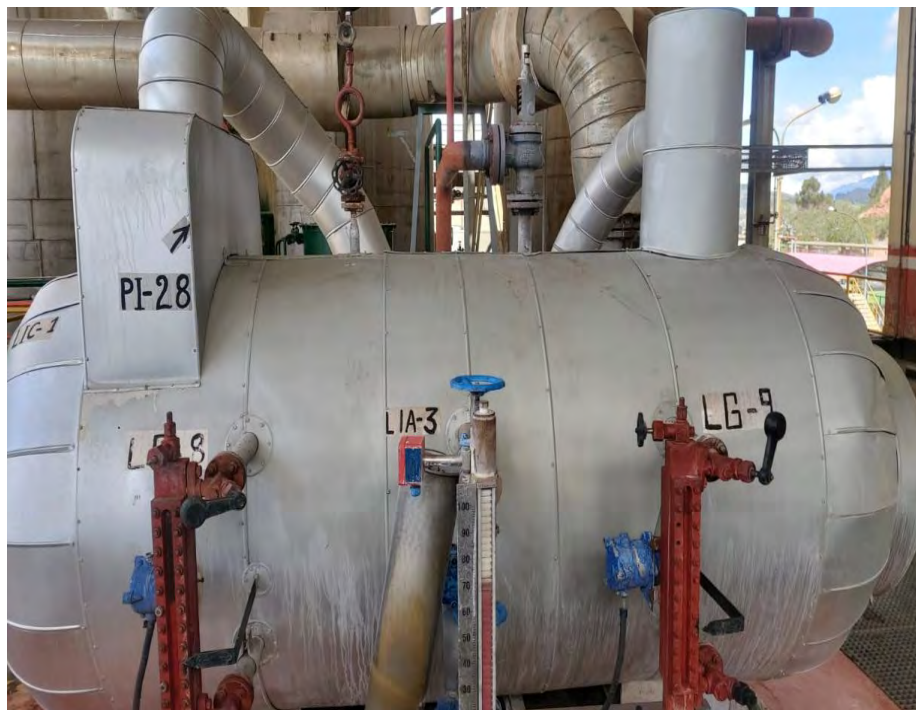
Domo de separador de fases
