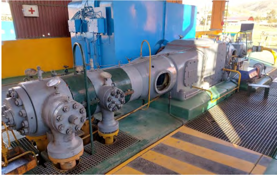
Compresor isotérmico del gas de síntesis de 4 etapas
