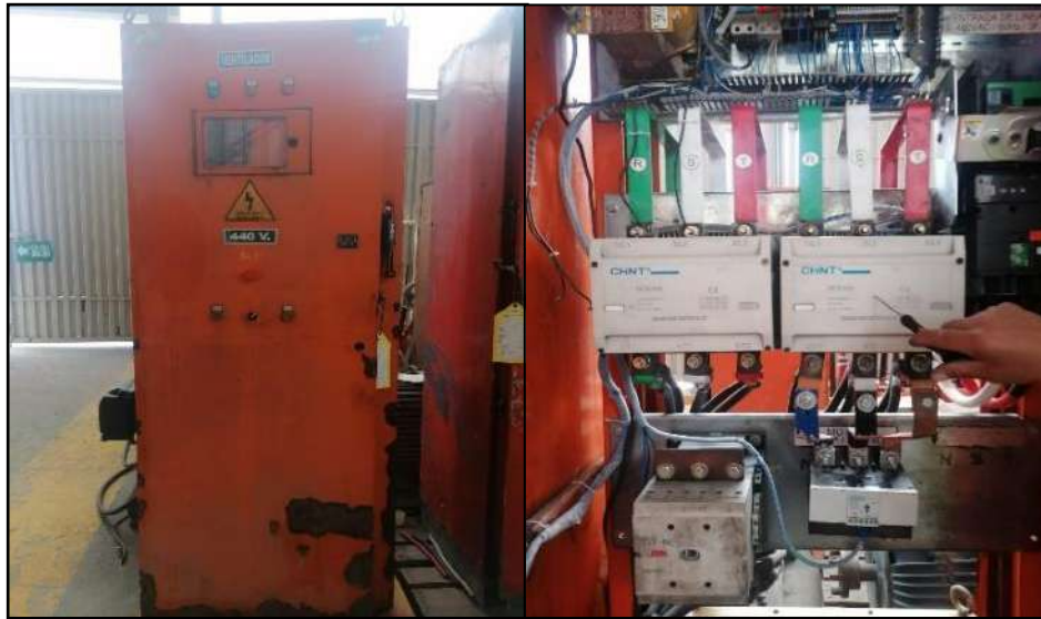
Figura 2 Tablero de Ventilador 440V
