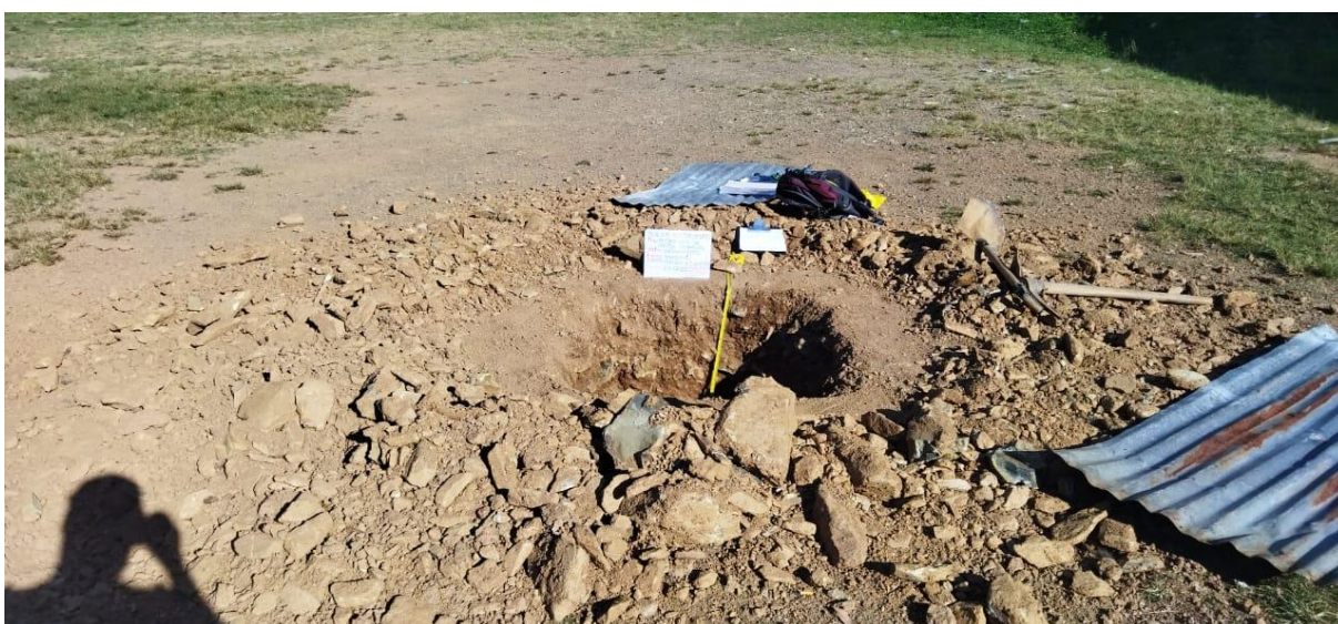
Foto N°12: calicata en la progresiva (02+0000) observándose estrato de una sola capa suelo muy duro de poca humedad y con conglomerados de diámetro de 10 a 20 centímetros, Fuente: Propia
