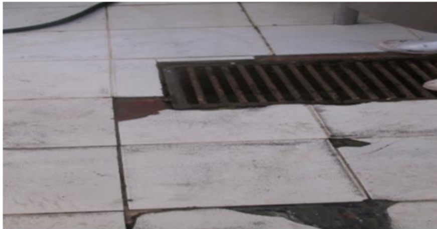
Imagen 1: El piso de la sala de proceso en mal estado
