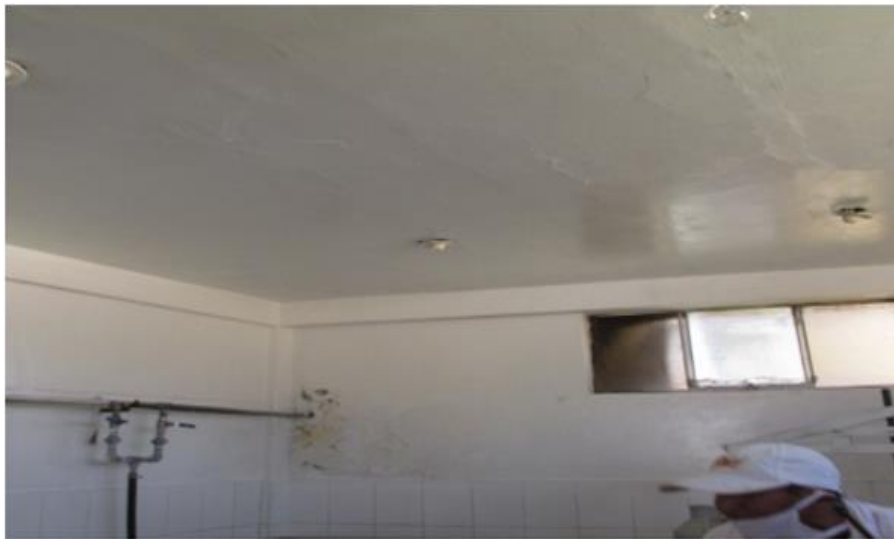
Imagen 2: Falta de luminarias y Limpieza en la ventana,
