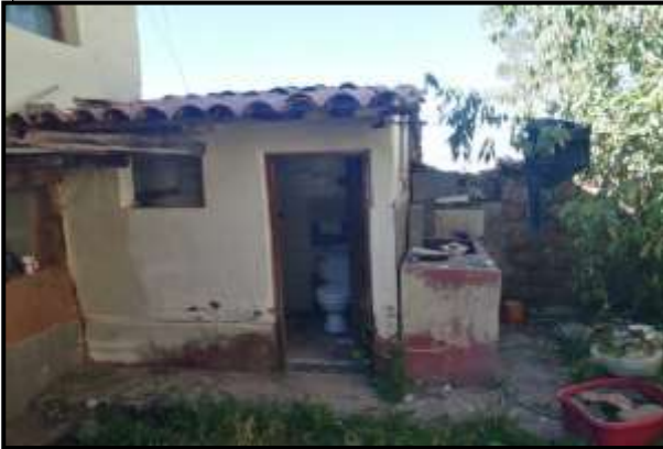
Condiciones actuales de un baño exterior típico en la zona de estudio, se observó viviendas que no tienen un baño y estos son hechos de manera provisional con arpillera.
