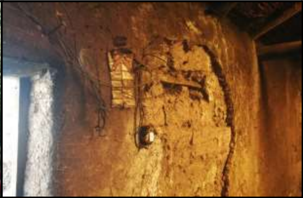
Instalaciones eléctricas superficiales en las viviendas, siendo este tipo de instalación la más común en la zona de estudio
