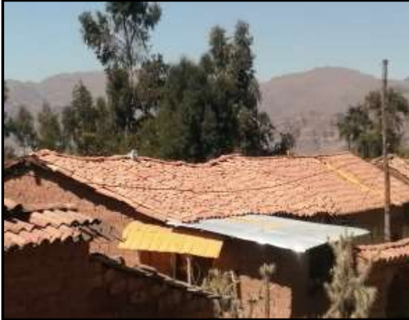
Techos ondulados de las viviendas debido a la antigüedad y falta de conocimiento en el diseño de techos.
