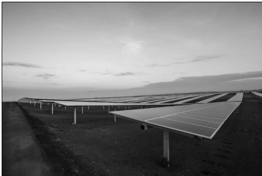
Figura 4. Vista de la planta solar de Rubí.
