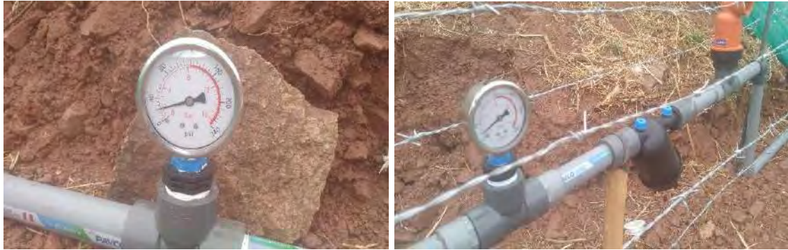
Fotografía 23. Manómetros instalados para evaluar la presión de flujo de agua en el sistema de riego
