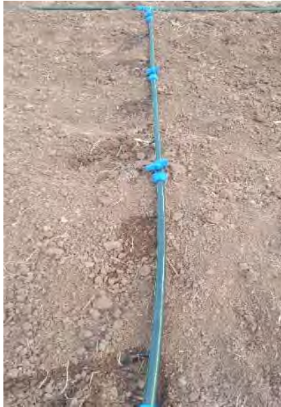
e) Tubería terciaria con 02 válvulas
