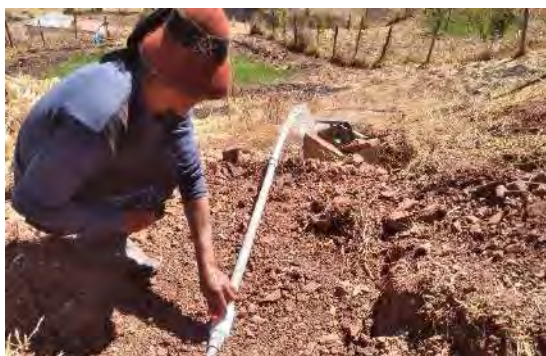
e) Prueba hidráulica y presión del flujo de agua en la captación de tubería secundaria.
