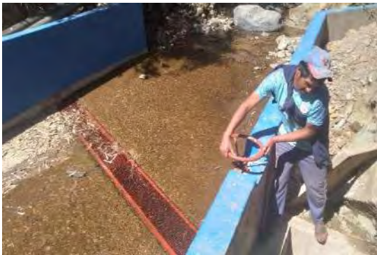
a) Regulación de la compuerta de la captación de agua de riego.
