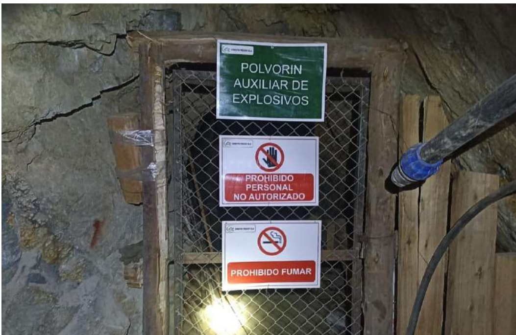
Figura 50: Polvorín auxiliar de explosivos
