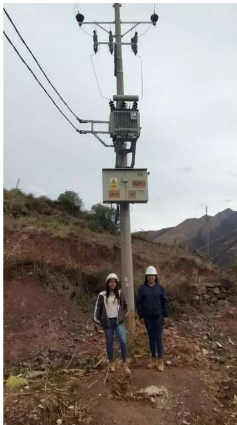
DESCRIPCION: INSTALACION DE EQUIPOS EN LA SUBESTACION ELECTRICA DE DISTRIBUCION 60432 LUCRE
