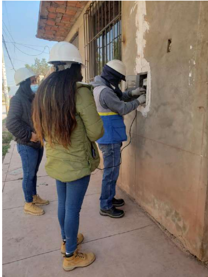
DESCRIPCION: INSTALACION DE EQUIPO DE MEDICION EN EL SUMINISTRO 001-08-01-205 CON APOYO DE PERSONAL DE LA EMPRESA ELECTRO SUR ESTE S.A.A.
