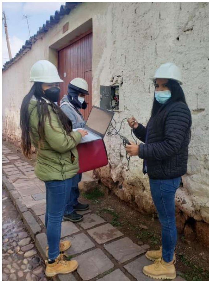
DESCRIPCION: INSTALACION DE EQUIPO DE MEDICION EN USUARIO 012-10-01-1096 CON APOYO DE PERSONAL DE LA EMPRESA ELECTRO SUR ESTE S.A.A.
