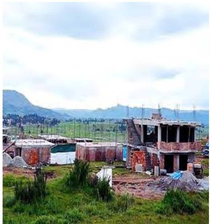
Visibles Construcciones, crecimiento poblacional en desorden sin autorizaciones
