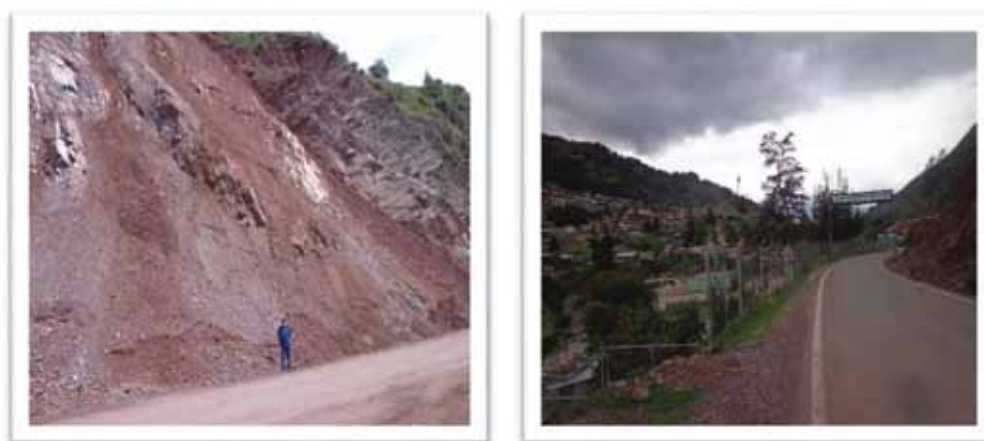
Figura 1. Ccaccañan de Una Falla por Deslizamiento-
