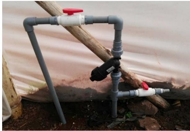
Fotografía N.º 08: Suministro de agua.
