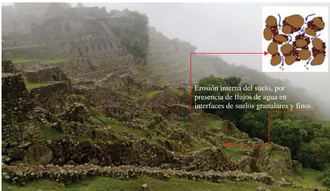
Figura 2.12: Proceso de Sufusión, en la Llaqta Inca de Machupicchu; Sector oriental. Un conjunto de recintos con mayor problema de conservación, por procesos de sufusión, que antes de colapsar presentaron agrietamientos, rastros de humedad por empozamiento de aguas pluviales, pérdida de inclinación original, crecida de vegetación, entre otros, previos a su colapso. Adaptado de Carlotto, Cárdenas y Fidel, 2009. Fotografías, archivo personal, 2017.
