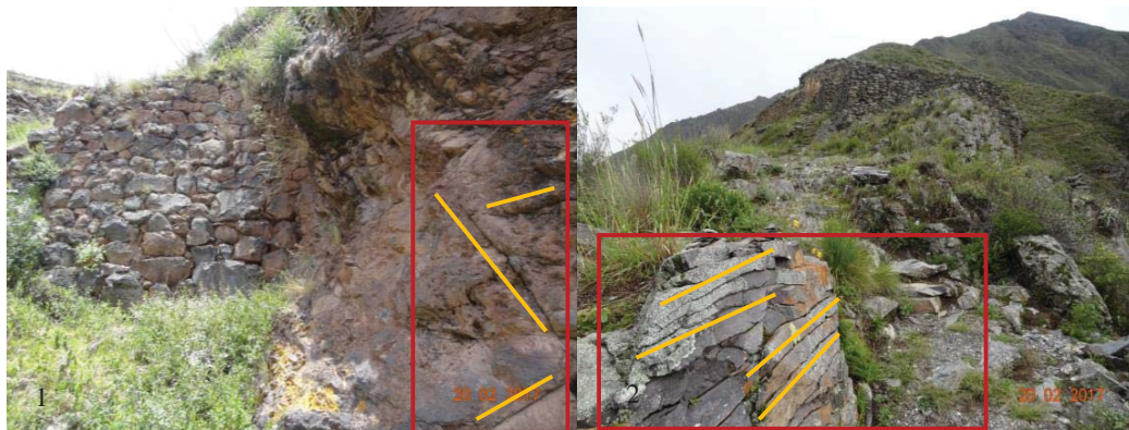
Figura 2.4: Sistema de Diaclasas de formación en suelos de fundación de Llaqtas Incas. En los recuadros rojos y, resaltados con líneas amarillas se muestran: (1) Q´aqqas con presencia de diaclasas en la Llaqta Inca de Ollantaytambo, y (2) Q´aqqas con presencia de diaclasas en la Llaqta Inca de Pisaq. Nótese que en ambos casos no hay desplazamiento de los macizos rocosos. Fotografías, archivo personal, 2017.
