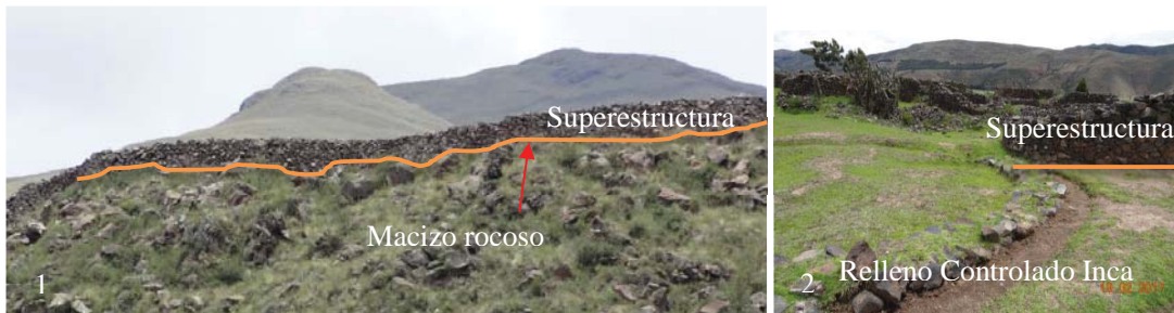
Figura 5.83: Tipos de apoyo de superestructuras en la Llaqta Inca de Raqchi . Línea naranja, superficie de apoyo: (1), Directo sobre macizo rocoso; y, (2) sobre Rellenos Controlados Inca. Una vez conocida la naturaleza y propiedades de los suelos de fundación, de seguro los Incas eligieron la solución de las cimentaciones más adecuadas, con base en la experiencia tecnológica que acumularon desde sus predecesores Pre Incas, como los Pikillaqta y los Choquepukio, cuyas cimentaciones se apoyan en macizos rocosos, facilitados por rellenos artificiales de suelo granular. Fotografías, archivo personal, 2017.
