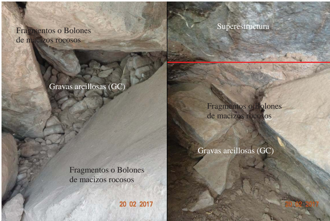
Figura 3.88: Rellenos Controlados Inca, en sus contextos originales III - Písaq. Composición trabajada de los rellenos, compuesta por fragmentos del sustrato rocoso, utilizando suelos mixtos (finos y granulares), como son las Gravas arcillosas (GC), cohesionando las gravas y, cubriendo los vacíos, para optimizar la compactación. Línea roja superficie de apoyo de la superestructura. Fotografías, archivo personal, 2017.
