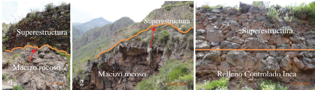
Figura 5.82: Tipos de apoyo de superestructuras en la Llaqta Inca de Písaq . Línea naranja, superficie de apoyo: (1) y (2), Directo sobre macizo rocoso; y, (3) sobre Rellenos Controlados Inca; éstos que constituyen los cimientos corridos, tienen un comportamiento similar al de una viga de cimentación; con este sistema, los Incas aseguraron dar la máxima rigidez a las cimentaciones e impedir que los muros absorban “solicitaciones inducidas por asentamientos diferenciales” (Rodríguez, et.al., 1989). Fotografías, archivo personal, 2017.
