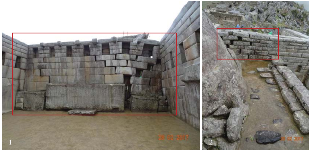
Figura 2.11: Asentamiento diferencial en la Llaqta Inca de Machupicchu. Los recuadros rojos evidencian (1) asentamiento diferencial en la pared norte del Templo Principal; (2) separación de juntas en las paredes norte y sur debido a asentamientos en el Templo de las Tres Ventanas; que probablemente se produjeron en el momento de su construcción (Carlotto, Cárdenas y Fidel, 2009). Fotografías, archivo personal, 2017.
