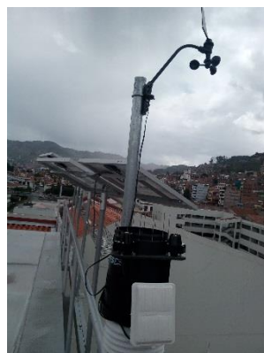
Figura 3-6 Estación meteorológica Vantage pro 2 instalada [Fotografía tomada en la UNSAAC]
